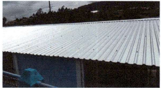
Foto 2: Sustitucion de capote
